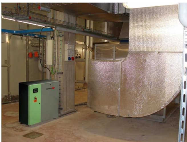
Рис. 11.2 Распылительный увлажнитель высокого давления в техническом помещении
