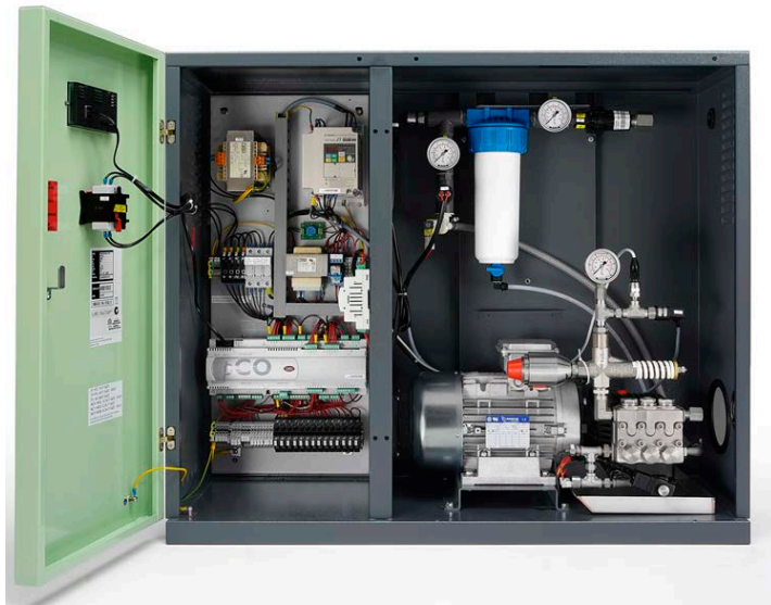
Только 1 шкаф с насосом
