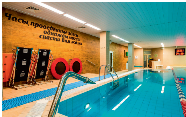
Фитнес-клуб с бассейном «ПАРУС», г. Санкт-Петербург Вентиляционные установки для бассейна Dantherm
