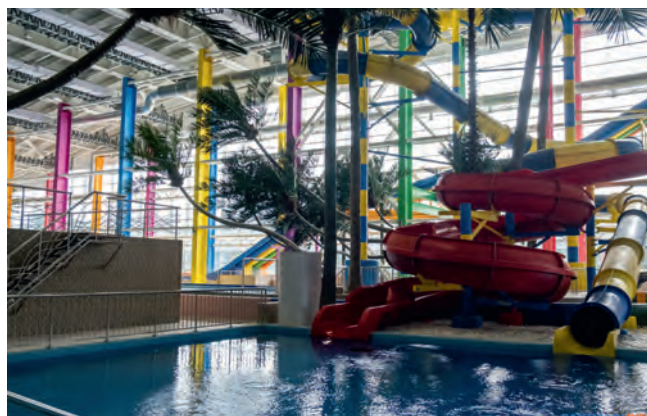
Аквапарк, г. Южно-Сахалинск Вентиляционные установки для бассейна
