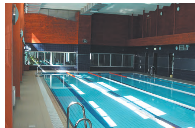
Физкультурно-оздоровительный центр «Аквабел» г. Минск Вентиляционные установки для бассейна
