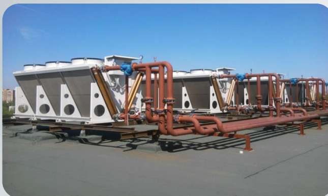
Дата центр Яндекс, г. Москва
