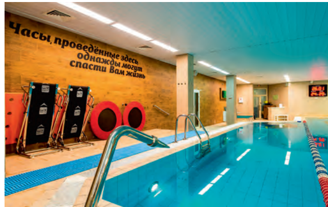
Фитнес-клуб с бассейном «ПАРУС», г. Санкт-Петербург Вентиляционные установки для бассейна
