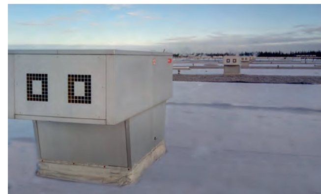
Склады готовой продукции кондитерской фабрики КДВ, Воронежская обл. Вентиляционные агрегаты Noval
