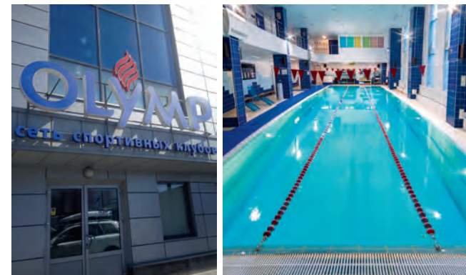
Фитнес-клуба «Olymp», Санкт-Петербург Вентиляционные агрегаты Dantherm
