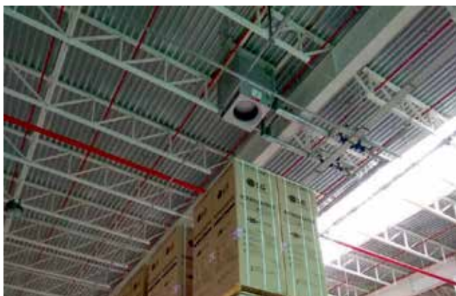
Складские помещения компании LG, г. Руза, Московская обл. Вентиляционные агрегаты Noval
