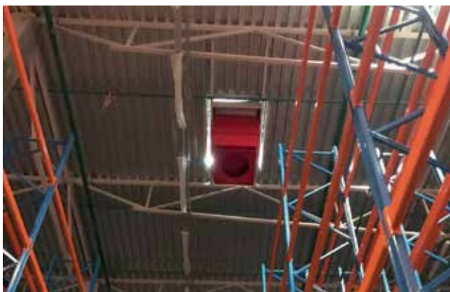
Дистрибьюторский центр IKEA, Московская область Вентиляционные агрегаты Noval
