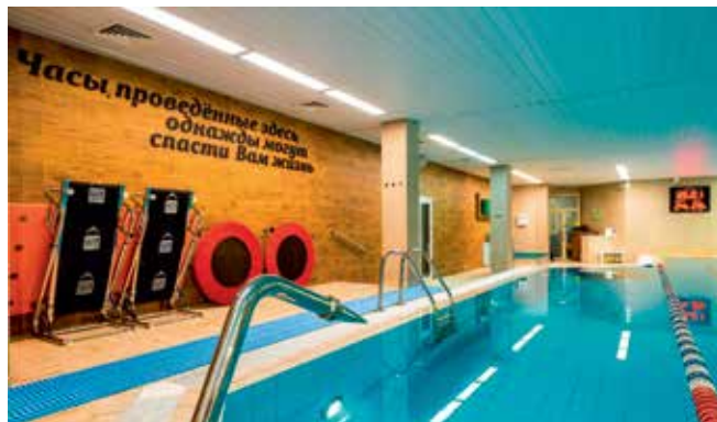
Фитнес-клуб с бассейном «ПАРУС», Санкт-Петербург Вентиляционные агрегаты Dantherm DanX 3/6 XWPRS
